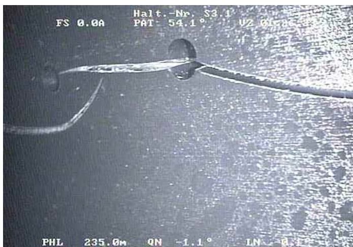
Abbildung 5 An einem Drainageloch beginnende Rissbildung
