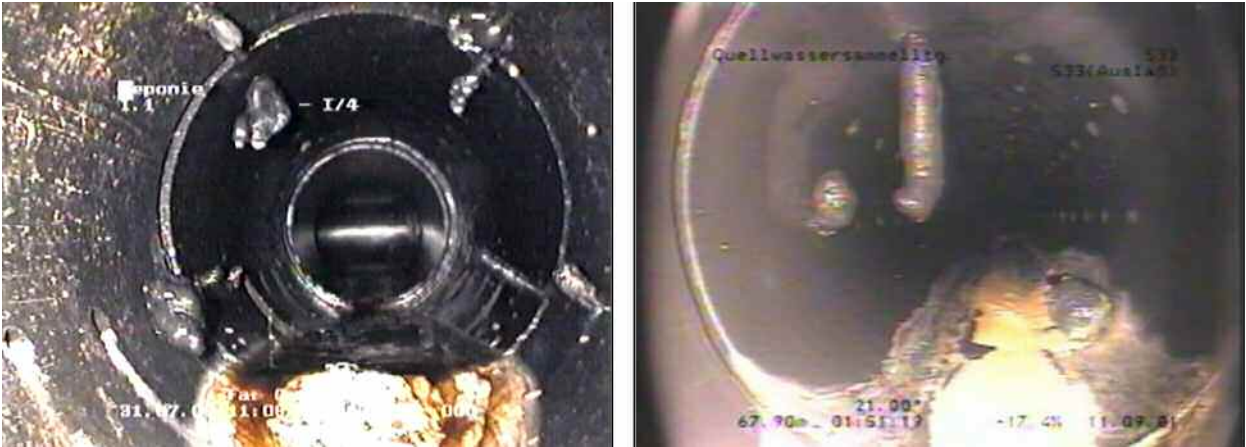
Abbildung 10, 11 Eingedrungenes PE-Material durch Verschweißung von gelochten Leitungen mittels E-Muffe
