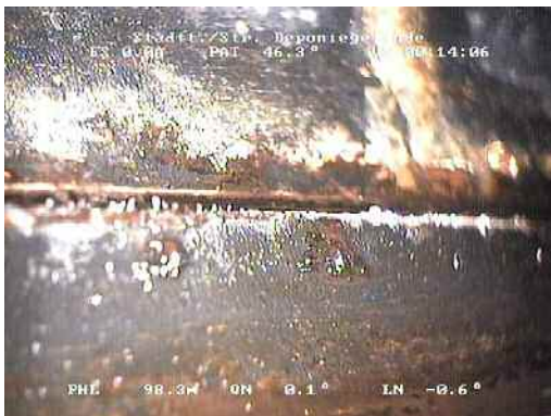
Abbildung 7 Riss in der Rohrsohle einer PE-Leitung
